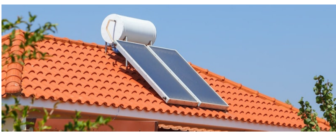
Fig. 7 - Impianto solare termico (dal sito https://www.enelx.com )
